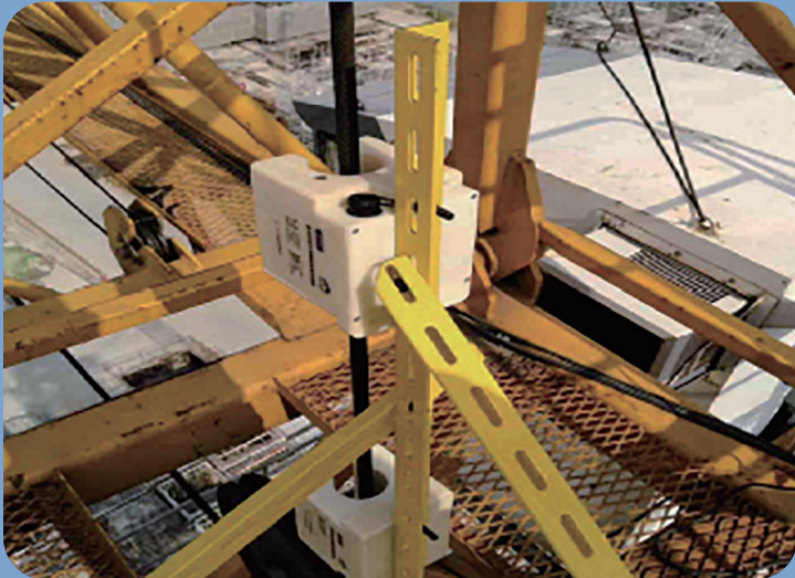
智慧塔吊监控系统
