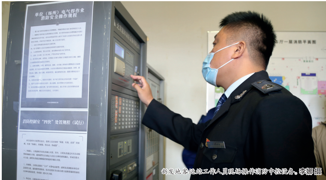
新发地地铁站工作人员现场操作消防中控设备。李娜摄
