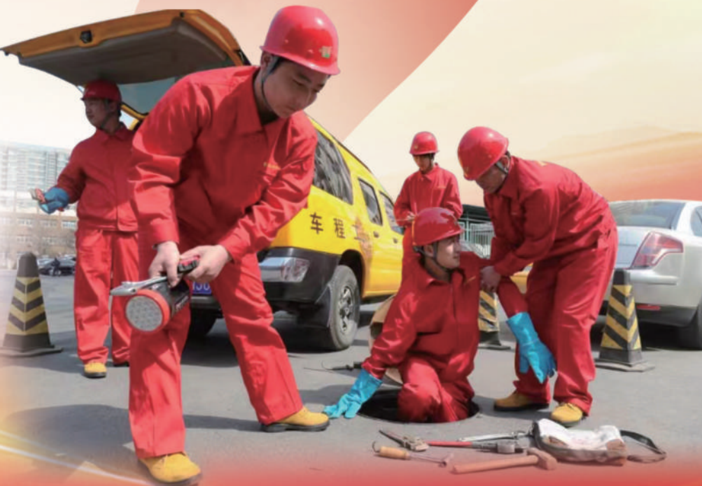
丰台供暖所严阵以待,全力保障供热平稳。
