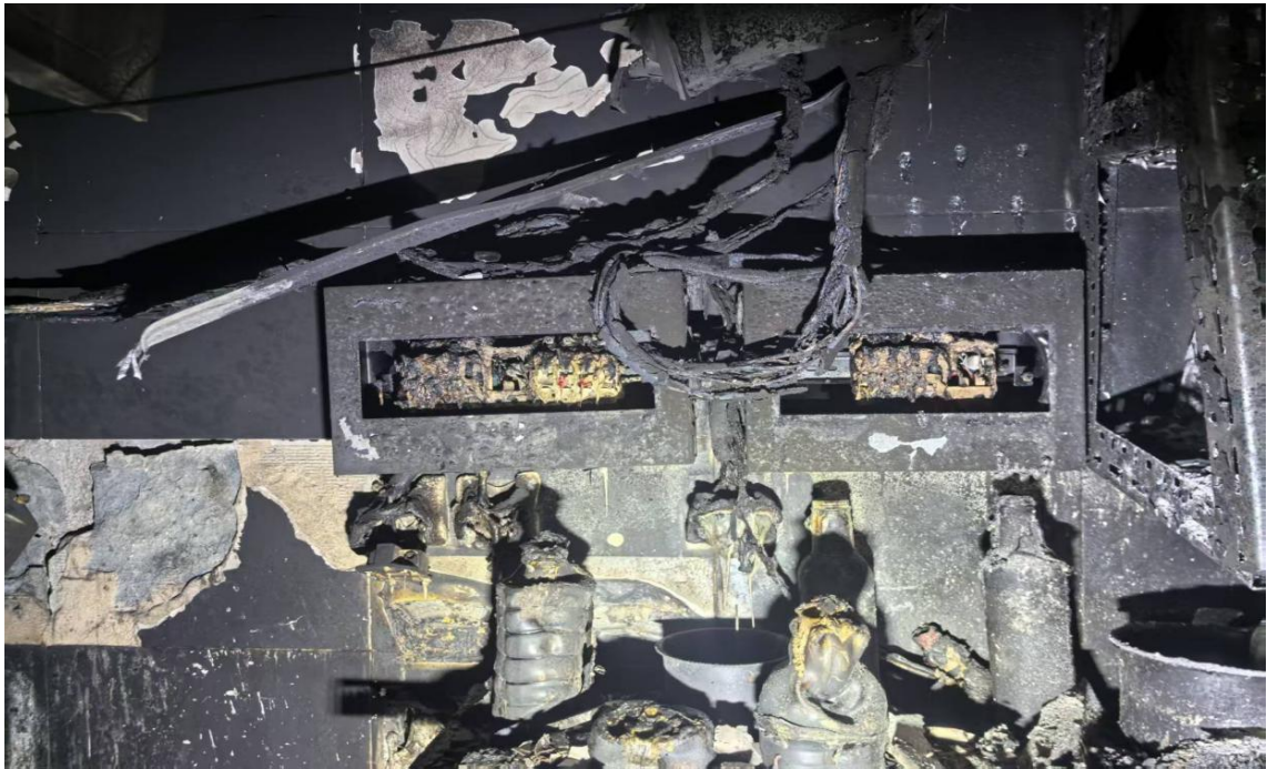
图 3.1.7：淮南牛肉汤米线店后厨区域西墙配电箱火灾后照片，证明起火部位 及周边电气线路上未发现故障点
