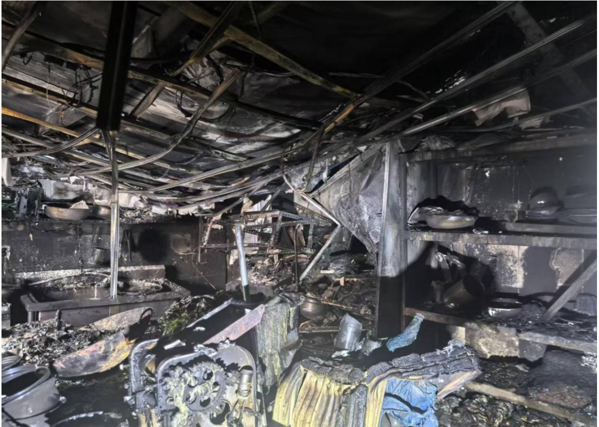
图 3.1.4：南墙的货架北侧上半部分受热变形严重，向北侧弯曲塌陷。靠南墙吊柜的金属龙骨受热变形变色北侧重于南侧，下部重于上部。
