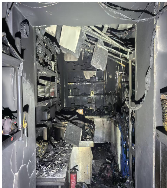
厨房火灾后照片
