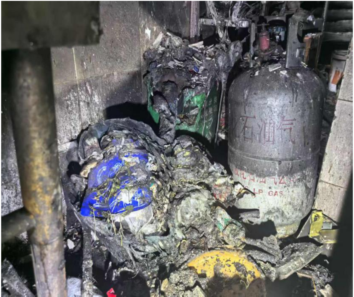
图 3.1.4：水槽东侧上部分受热变色痕迹重于其他部分。水槽东侧 0.3 米距地面 1.1 米处的墙面上有一处近圆形瓷砖被烧爆脱落痕迹，其下方塑料凳子上半部分已经完全熔融塌陷，可推断就是炉头所在原始位置。
