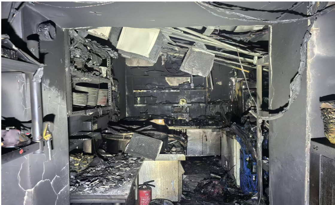
厨房火灾后照片（从门口处由南向北拍摄）
