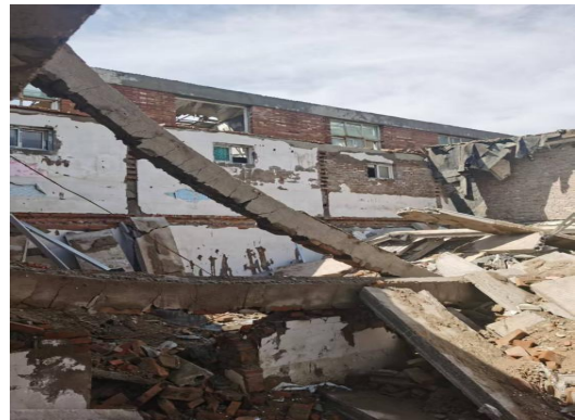
（事故现场钢梁被埋在预制板下）
